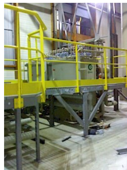
Tuyauterie industrielle Installations chimiques Groupe Salgiter
